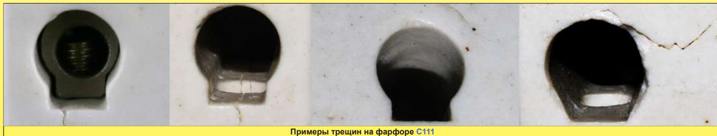
Примеры трещин на фарфоре C111
